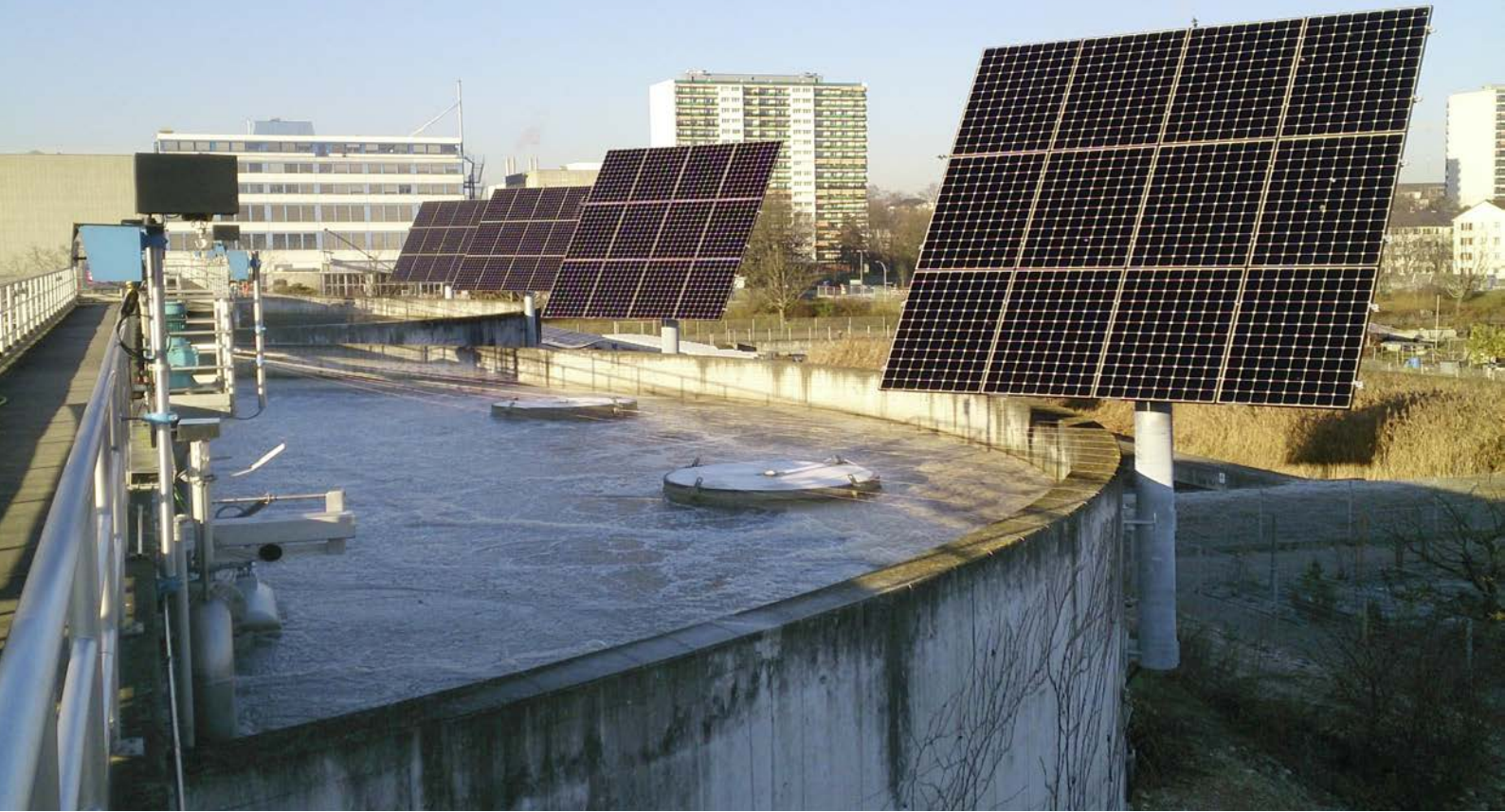
Nachführsysteme an einer Kläranlage in Birsfelden in der Schweiz: Montiert wurden Degertracker 3000 HD, die jeweils zwölf Module tragen.
